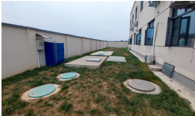
升压站内绿化
