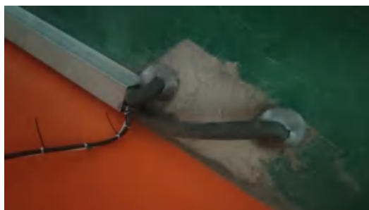
探伤室外电缆口
