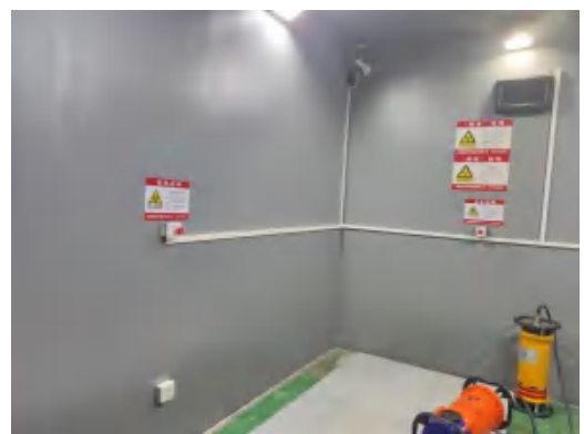
探伤室内监控及急停开关
