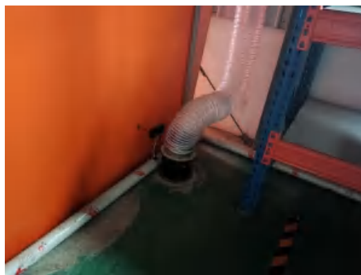
探伤室外排风管道
