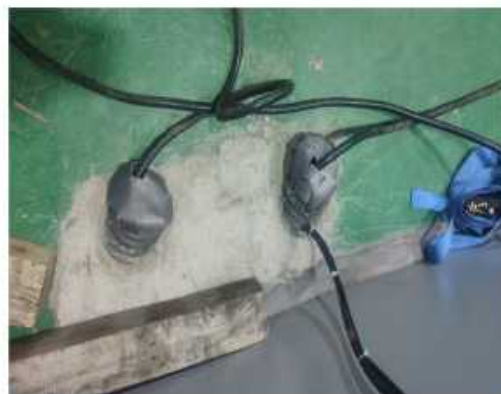
铅房内电缆口
