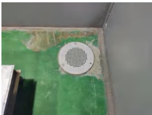
探伤室内排风口
