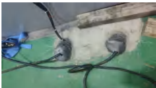
探伤室内电缆口
