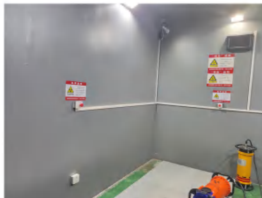
铅房室内急停按钮及监控
