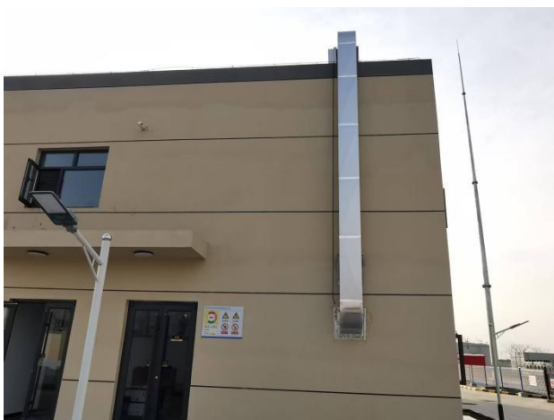
升压站食堂油烟净化器排气管道
