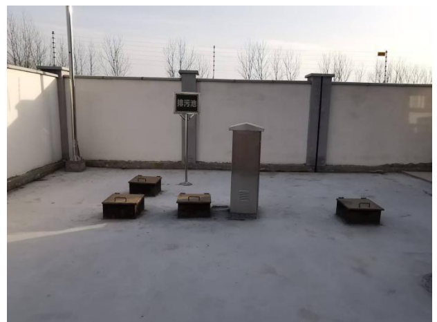
升压站一体化污水处理设施
