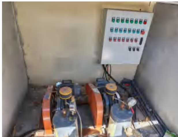
污水处理设施
